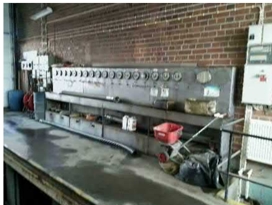
Valokuva 89. Huoltohallissa käsitelty runsaasti öljyä, öljysäiliöt lattian alla.
